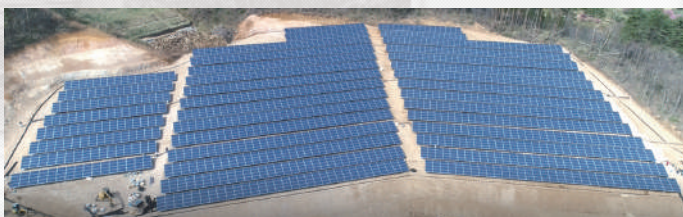
ウエストランバー福島県蛇音山発電所 (1290kW)
