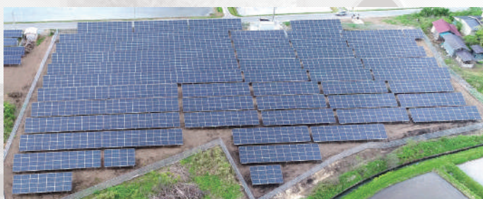
西尾木材岩手県中谷内発電所 (723kW)
