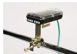
ソーラーユニット設置例 1
