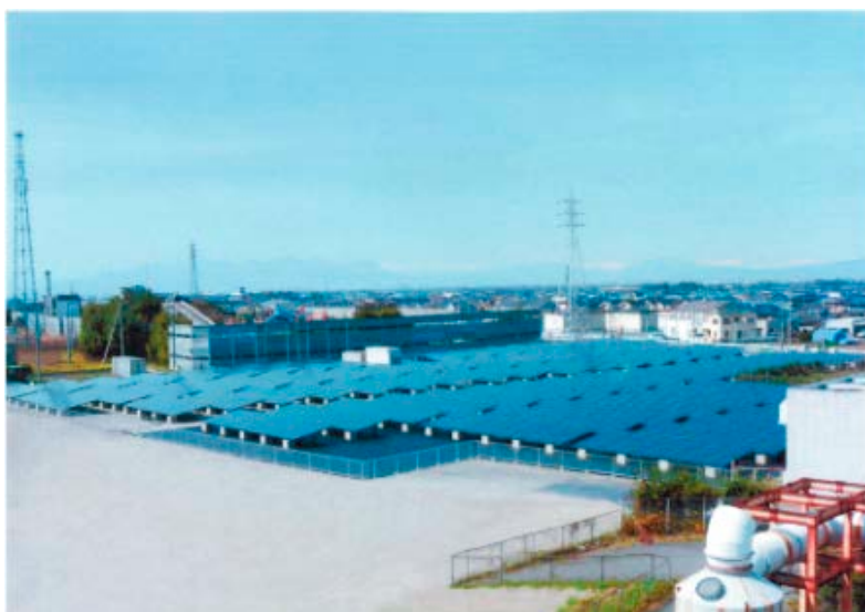
図44 メガソーラ発電所 (大成温調株式会社より資料提供)
