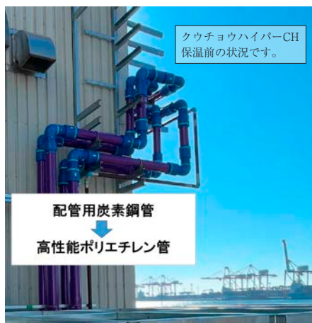
図37 海岸沿いの工場（出典：SEKISUIエスロンタイムズ） （川崎設備工業株式会社より資料提供）
